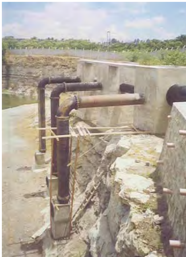
Figura 5.2: Detalhe da tubulação de chegada dos esgotos na lagoa anaeróbia, onde o esgoto bruto entra pelo fundo da lagoa
